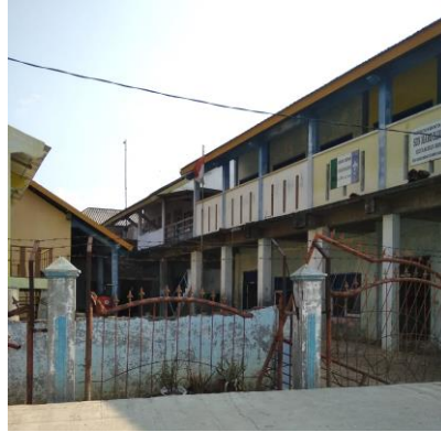
Gambar 3. Bangunan sekolah rusak akibat banjir rob (Dokumentasi Pribadi)
