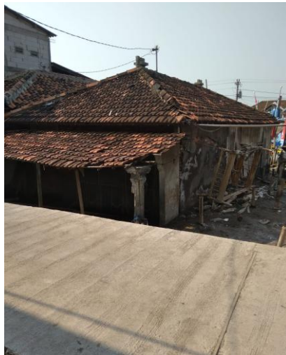
Gambar 5. Kondisi rumah warga akibat peninggian jalan (Dokumentasi Pribadi)
